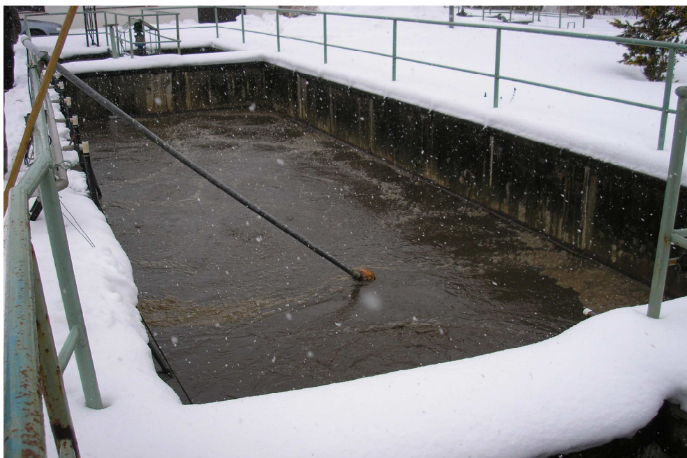
Obr. 5: Aktivační nádrž ČOV Obrataň
